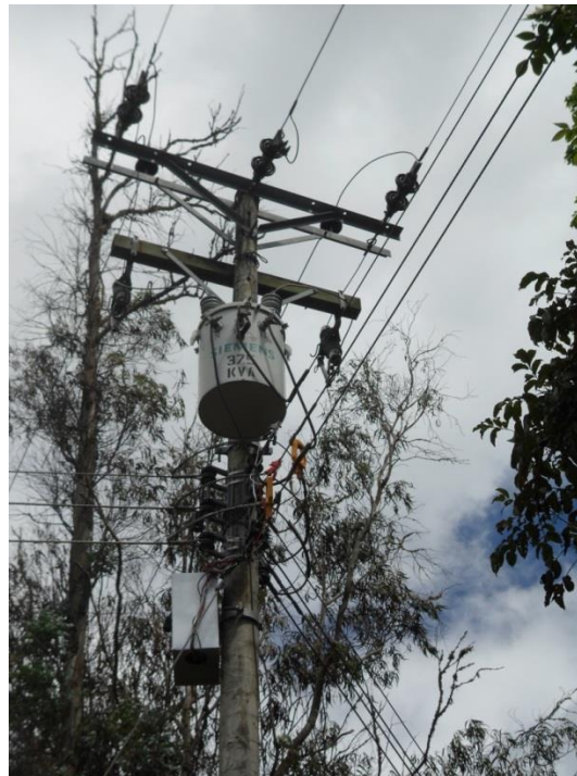
Figura 28. Analizador de redes instalado en el Tambo
