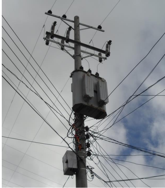
Figura 44. Desorden en la conexión a la red de distribución en baja tensión. Fuente: esta investigación
