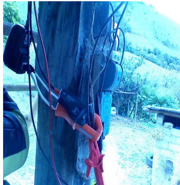
Figura 5. Datalogger instalado vivienda 2
