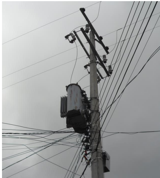
Figura 45. Transformador antiguo ubicado en el corregimiento de Anganoy. Fuente: esta investigación
