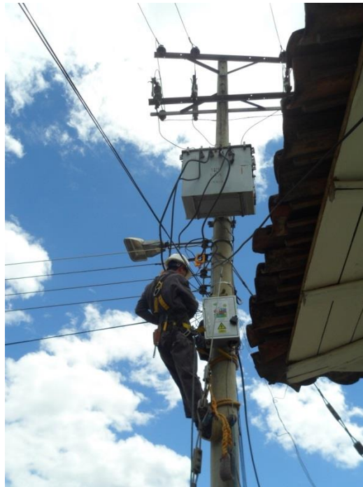
Figura 29. Instalación del analizador de redes en la vereda el Ingenio del Municipio de el Sandoná
